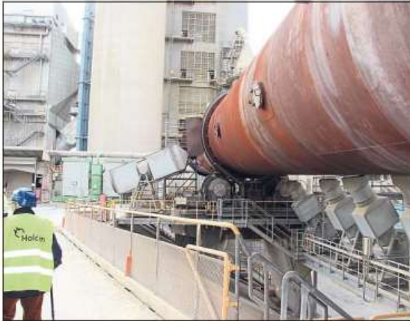
Der Zementproduktion hat sich das Werk Am Kollenbach seit mehr als 100 Jahren verschrieben.
